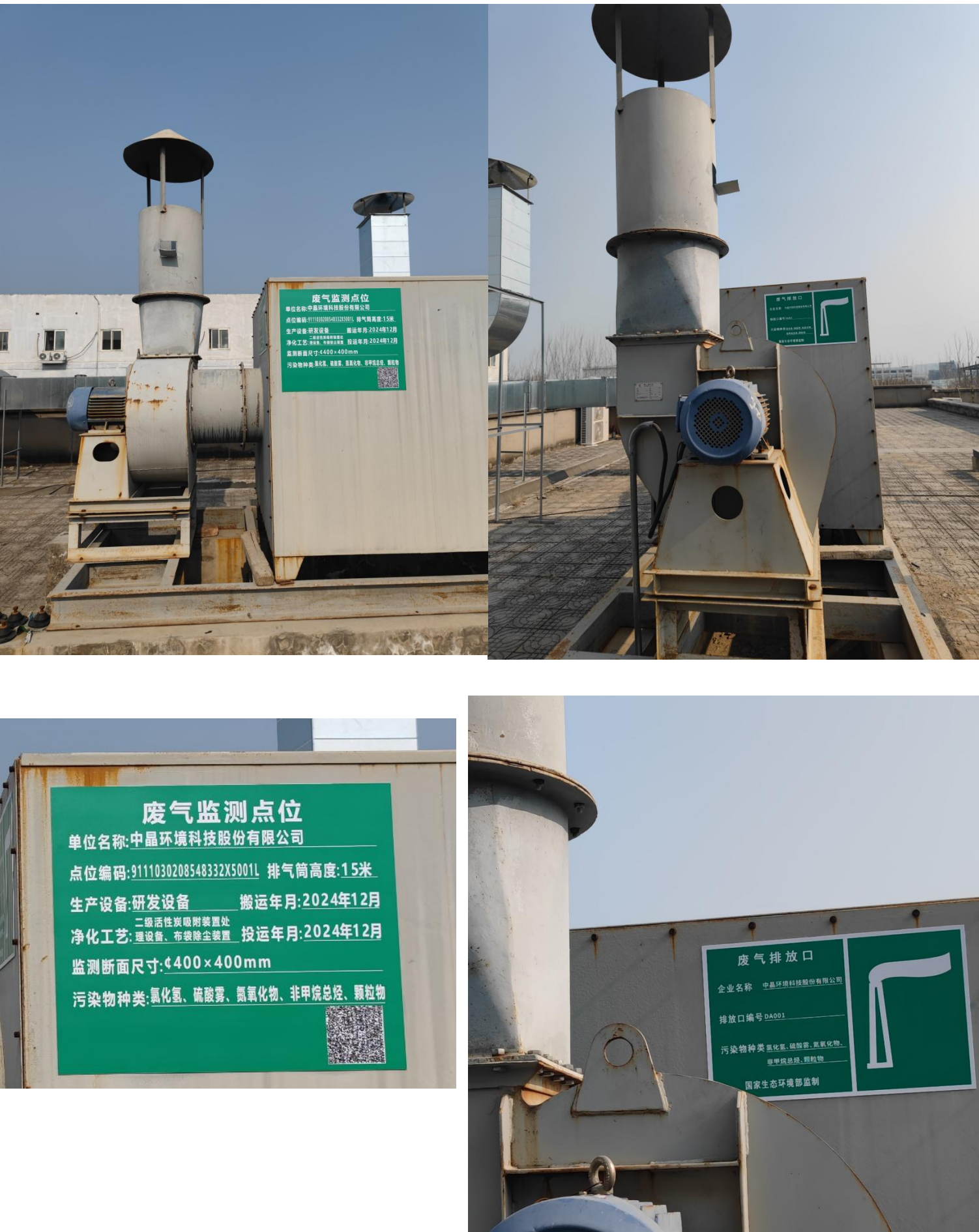
附图 1 排气筒、排气筒标识牌及监测点位标识牌照片
