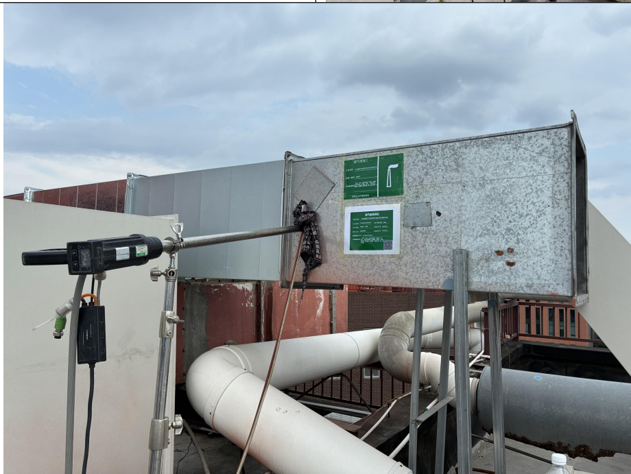
通风橱、废气排放口以及活性炭吸附装置
